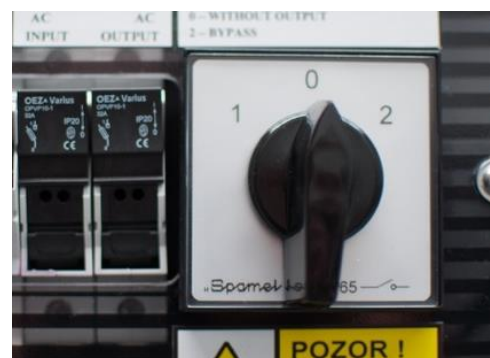
Obrázek 5 - Hlavní vypínač, bypass
