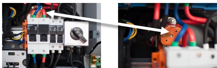
Obrázek 27 - umístění odpínače fotovoltaických panelů
